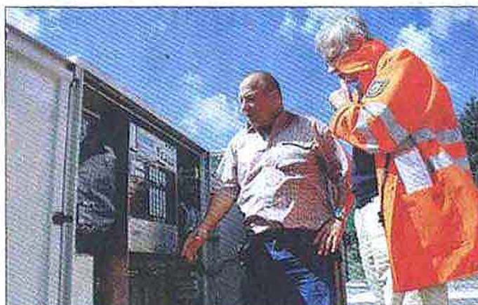
Peter Hötzl von der Firma Signalbau Huber (links) erläutert Baudirektor Herwig Holme vom Regierungspräsidium die Technikzentrale der neuen Ampelanlage. Fotos: Stiefenhofer
